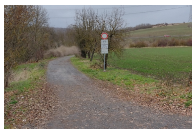
Bergstraße zwischen Oberhütte und Volkrode: unebener Belag
